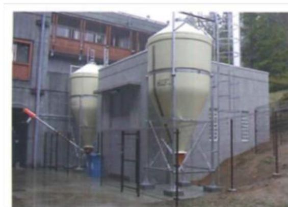
ペレットボイラー(名栗げんきプラザ)
