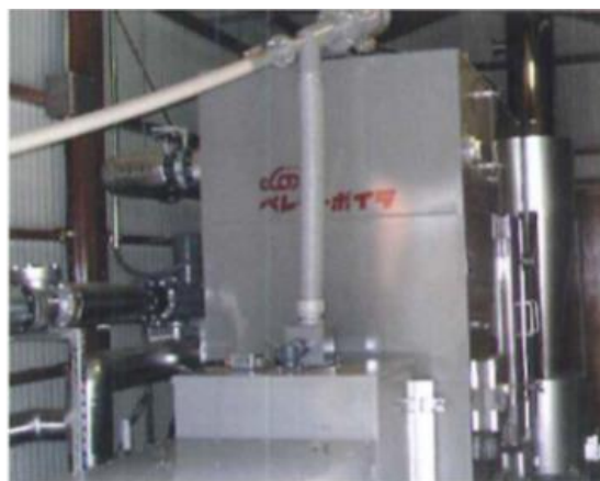
ペレットボイラー(さわらびの湯)
