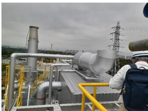
ボイラー棟最上階 排気筒
