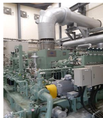
蒸気タービン
